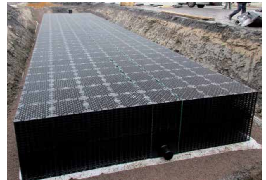
Fertig gestellte Retentionsanlage
